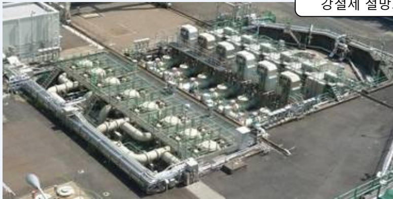
[토네이도 비래물 대책 설비 설치 전]
